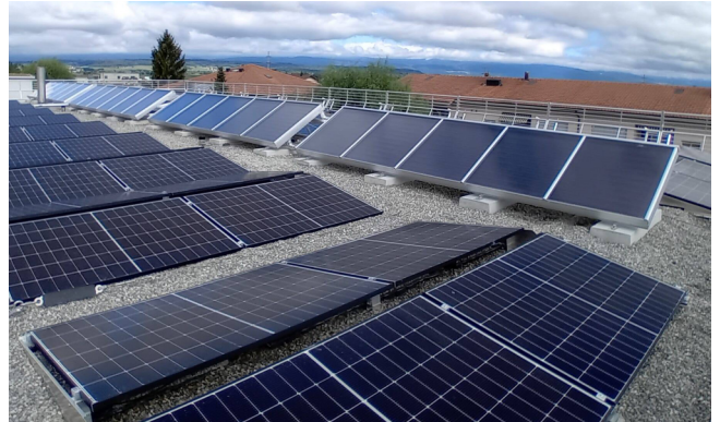
Photovoltaik (PV) und thermische-Kollektoren auf einem Dach
