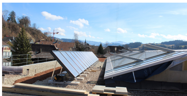
Solarthermie und Photovoltaik auf Flachdach in Langnau
